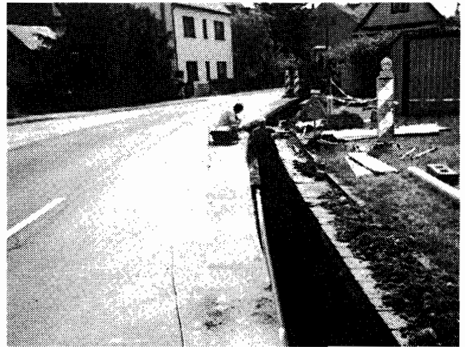
Auf der Lungwitzer Straße wird im Auftrag der Stadtwerke Lichtenstein eine Gasleitung verlegt. Jeder Anwohner, der dies möchte, kann sein Haus an die zentrale Gasversorgung anschließen lassen.
