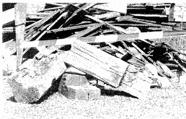
Die Kirchturmerneuerung wurde dringend erforderlich, dass beweisen diese alten Balken.
