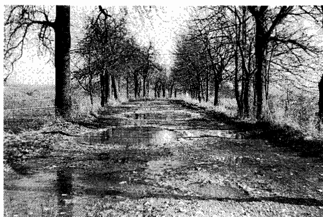
Die Straße im Zustand 1999. Diese Strecke war vor 70 Jahren asphaltiert, vielleicht wird mal ein schöner Wanderweg daraus.
