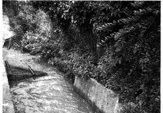
Hochwasserschäden am Tempelbach 25. 7. 1997.
