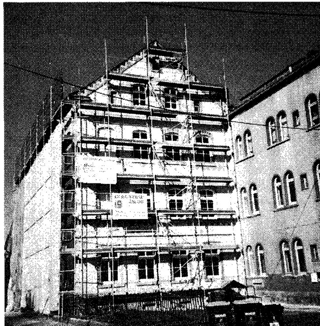
Das Foto vom März 1997 zeigt das eingerüstete Büro- und Wohngebäude. Heute erstrahlt es in neuem Glanz.
