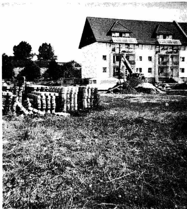
6. Aufräumarbeiten an der Schulstraße - das hier abgelagerte Material wird für das Anlegen von Stellflächen verwendet.
